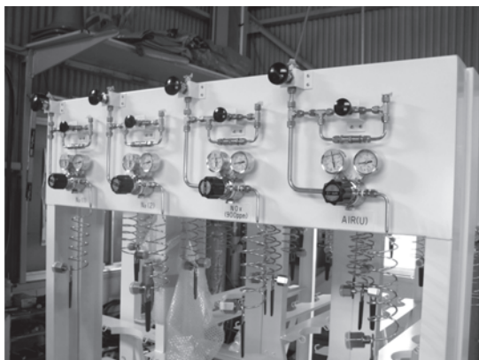
図 7 ボンベマニホールド架台機器
