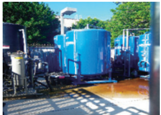
図 16 燃料蒸発ガス回収設備
